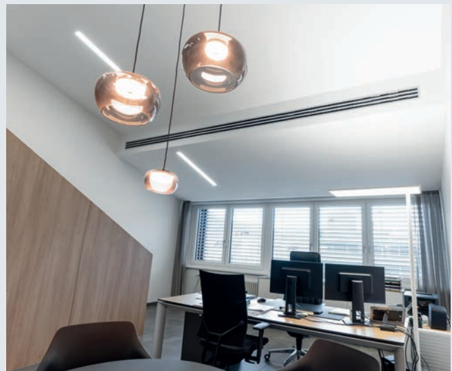
Kancelář společnosti Troyer Fliesen & Marmor GmbH, Innsbruck, EDMUND SPARER Klima & Kältetechnik GmbH
