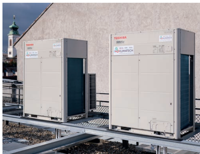
Kanceláře a technické místnosti Windmühlgasse, Vídeň, Klimatech Wärme Kälte Klima
